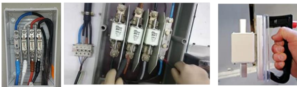
Fig. 5 Caja General de Protección con fusibles extraíbles con maneta
