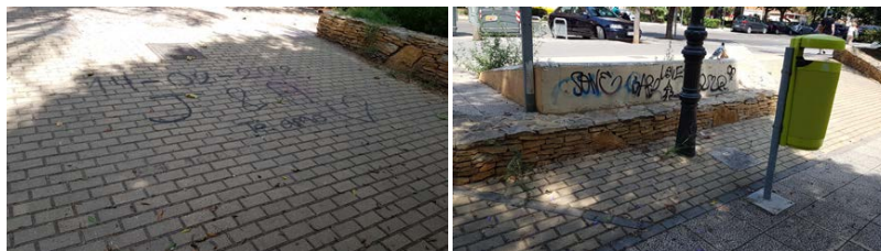
Figura 3: Pintadas en suelo y paramentos verticales.
