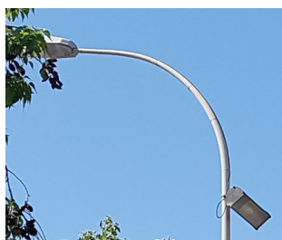
Figura 2: Detalla de la luminaria extra implementada en sobre el soporte de alumbrado de calzada.
