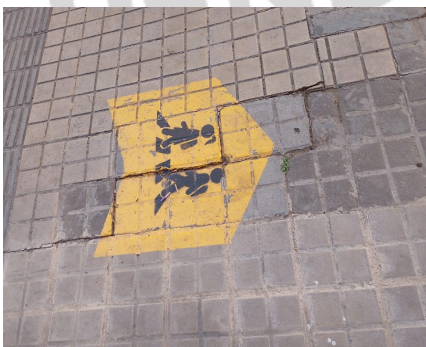
C/ Rodríguez de la Fuente, 18 Hundimiento de pavimento.
