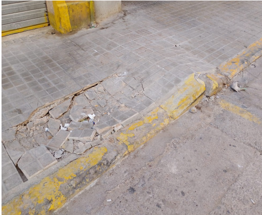
C/ Cambrils, 3 Deterioro de señalización peatonal y pavimento.
