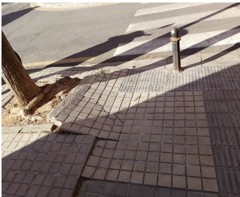
C/ Marqués de Montortal, 92 Socavones y baldosas levantadas.
