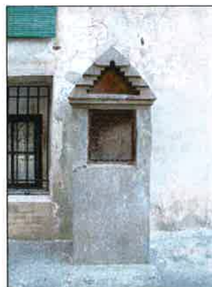
Chimenea de ventilación externa
