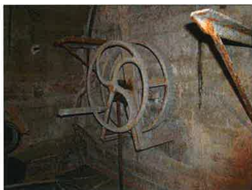
Apertura interior del sistema de ventilación
