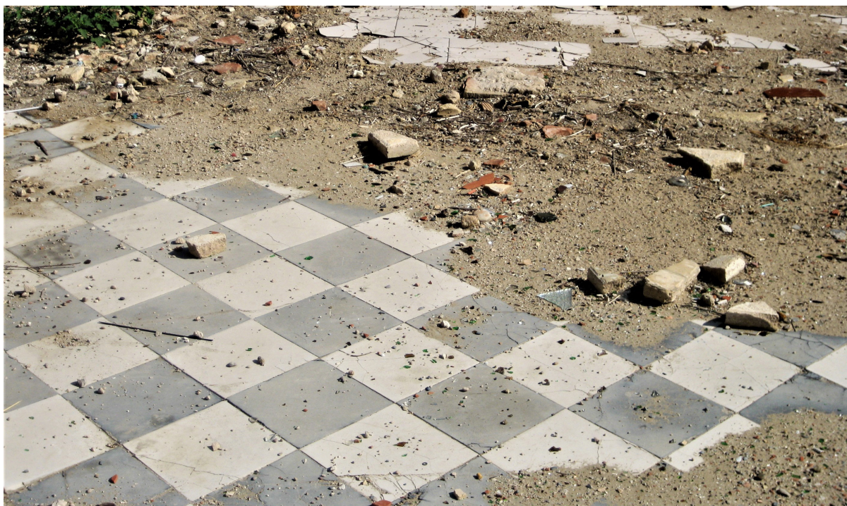
Figura 237. Restos de pavimento de baldosa hidráulica. (Pastor, R. 2010)
