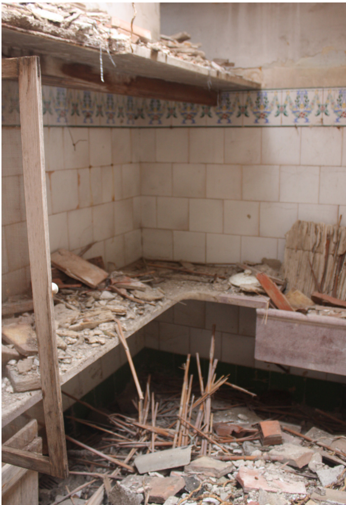
Figura 229. Restos de alicatado en zonas húmedas de vivienda. Calle Nicolau de Monsoriu 30. (Pastor, R. 2016)
