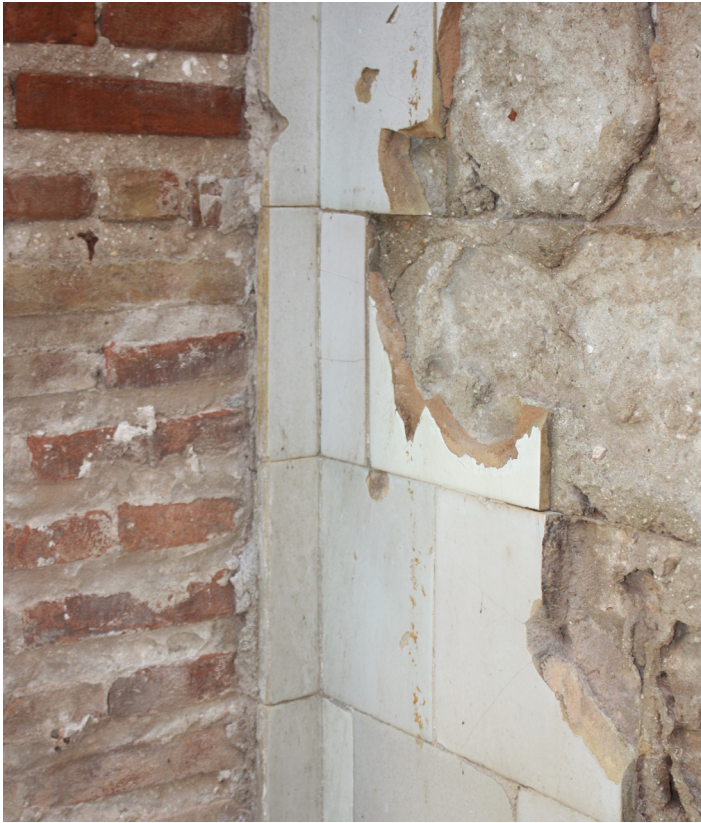
Figura 228. Restos de alicatado en zonas húmedas de vivienda. Calle del Rosario. (Pastor 2010)
