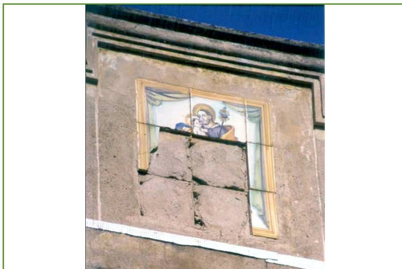
Arriba, ubicación del panel en el frontón del edificio (2018). Sobre estas líneas, estado del panel antes de su restauración (Fuente: Catálogo Estructural de Bienes y Espacios Protegidos).
