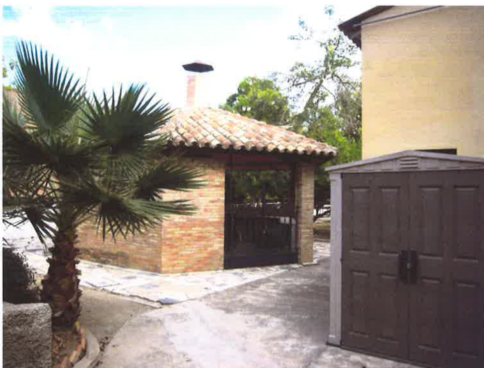
FOTO 7J · AREA DEL JARDIN NORTE · EDIFICIO HEXAGONAL (BARBACOA) AFECTADO
