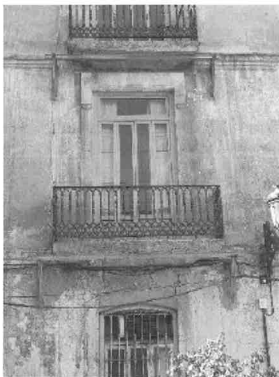
2. Estado de los balcones
