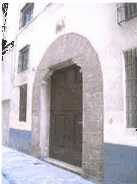
Vista de la portada de piedra donde se observa el escudo deteriorado
