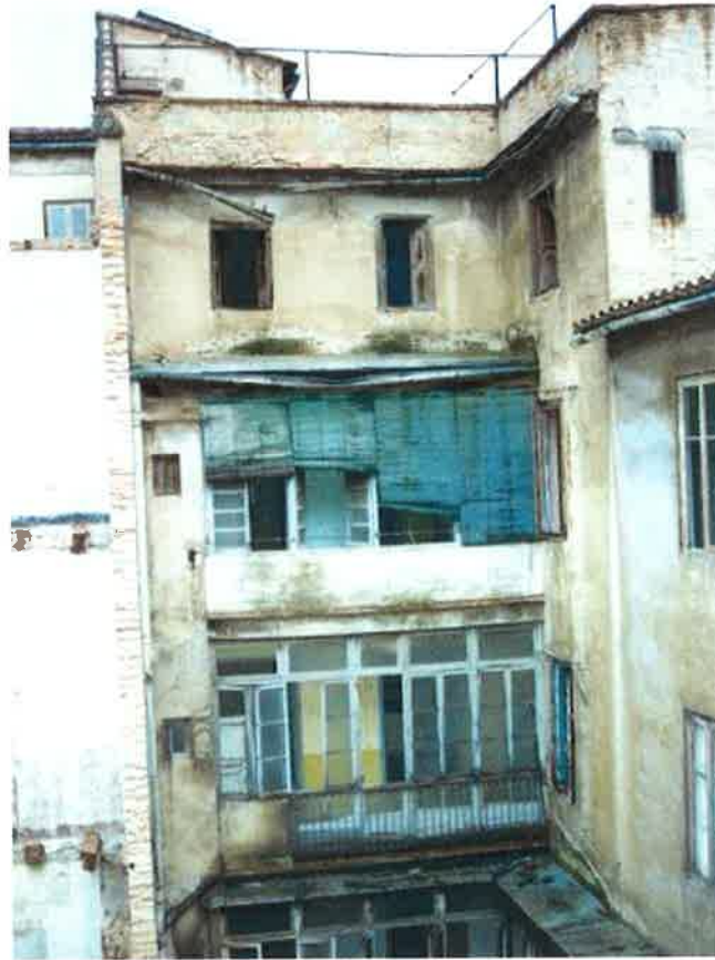
Degradación constructiva y material del patio interior
