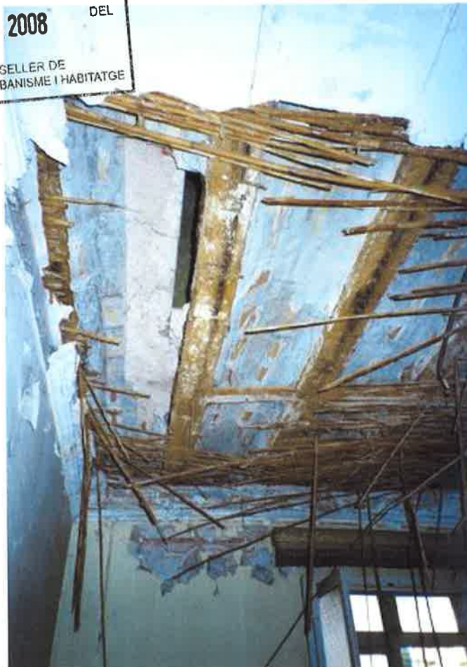
Forjado afectado por entrada de aguas en cubiertas
