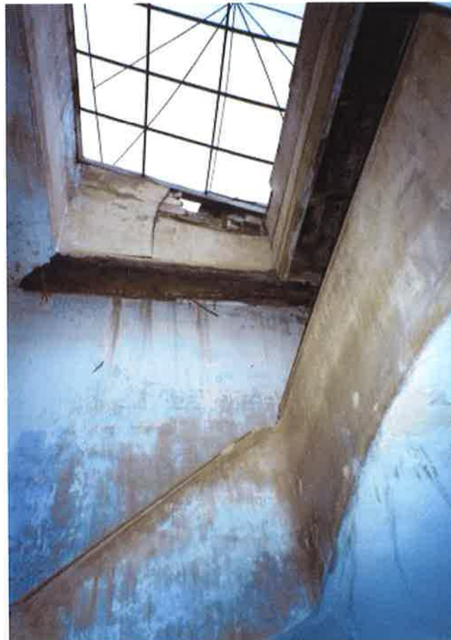
Lucernario. Deterioro producido por deficiencias de diseño, agotamiento de materiales y ausencia de mantenimiento
